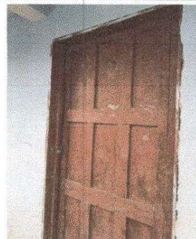
Foto 2: Sustrucción de puerta aula 2
